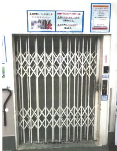
荷物用昇降機（改善前）
