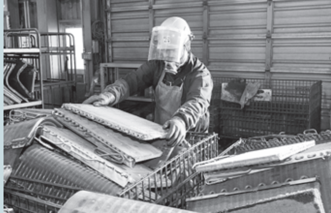
破碎工程に向け、熱交換器を大型のカゴに移し替える水本さん
