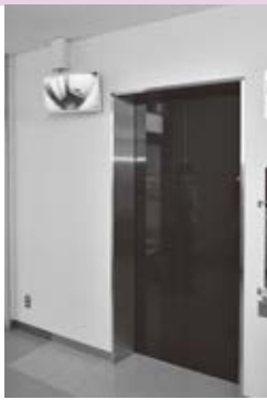
エレベーター内が確認できるモニター（左上）。災害時、閉じ込めの確認などに活用される
