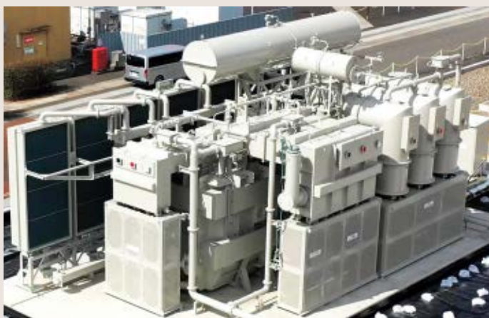
千葉工場の主力製品である大型変圧器。受注生産により、半年～1年程度をかけて製作される
