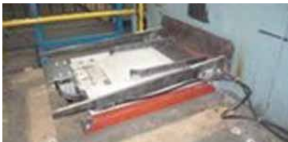
写真15 支援機器 パレット昇降装置
