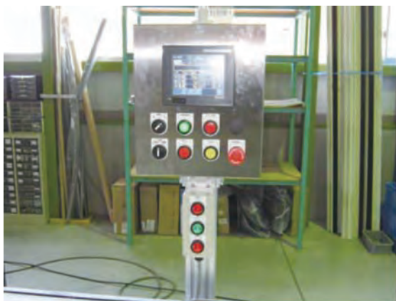
写真 19-1 計量器での指示モニター
