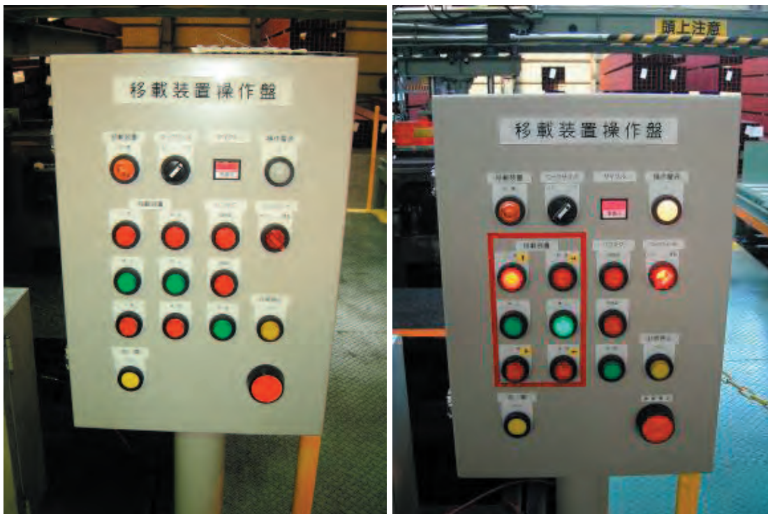
図一Ⅲー１１ スイッチの状態（左：改善前，右：改善後）
