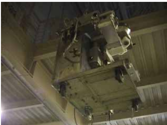
釣上用巻き上げ機 写真 9
