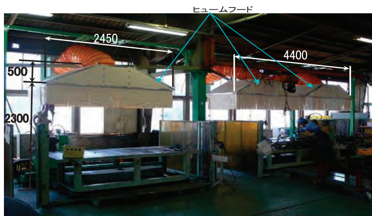
図表Ⅲ-23 改善後のロボット溶接機C・Dヒュームフード
