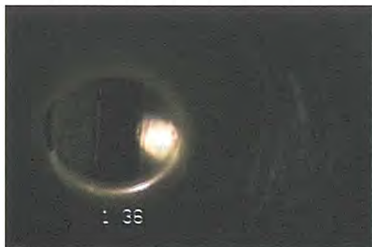
ダクト形状変更後横引きダクト内状態
