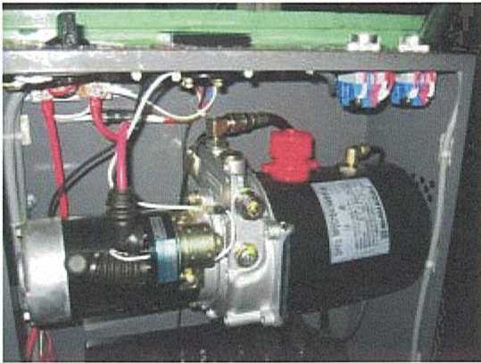
* 電気回路の改造は社内 (写真9)
