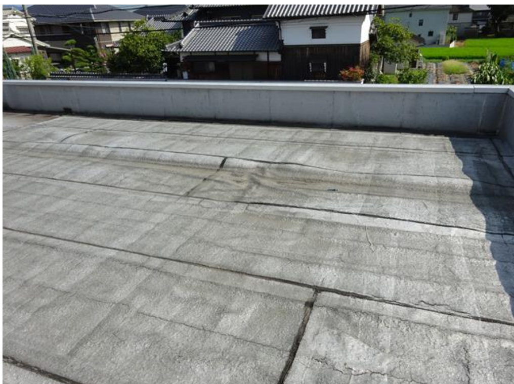
■ 地域センター 屋根アスファルトシート防水層の劣化（破断、ふくれ）
