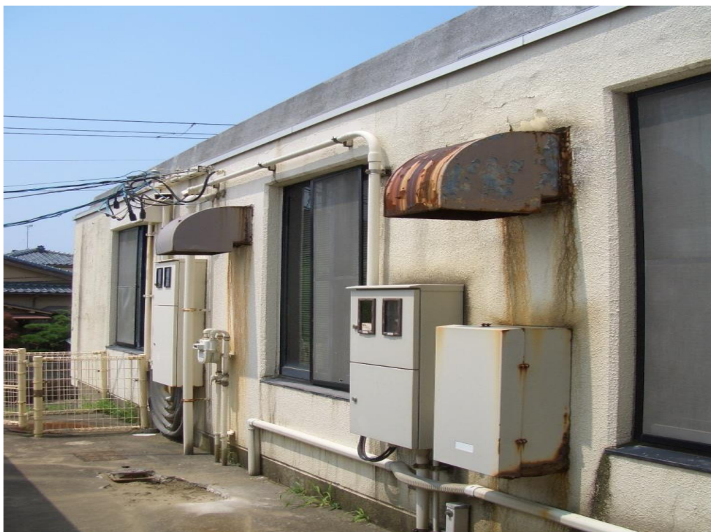
■ 地域センター 外部仕上げ塗材の経年劣化（はがれ、錆）
