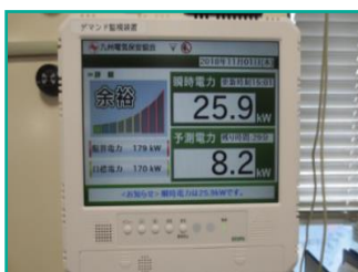
電力使用監視装置によるピークカット対策
