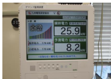
電力使用監視装置による ピークカット対策
