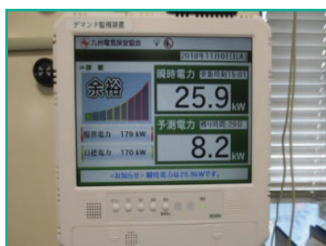
電力使用監視装置によるピークカット対策
